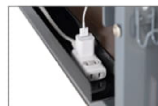
幕板裏側に配線レールがあります
